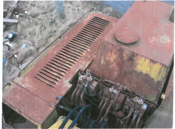
Fot. 20 Widok koparki – stan techniczny wyposażenia
