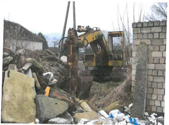
Fot. 2 Widok maszyny/ koparki – przedni lewy
